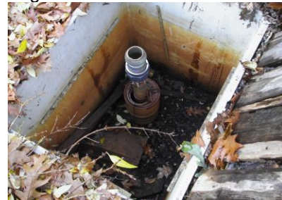
Waterpunt voor pompaansluiting
